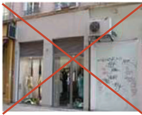
Contre exemple de climatisation, trop voyante et mal intégrée
